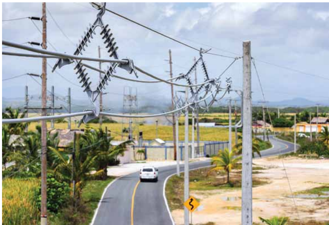
Parte de nuestra línea de transmisión ecológica en Uvero Alto. Our ecologic transmission line at Uvero Alto.
