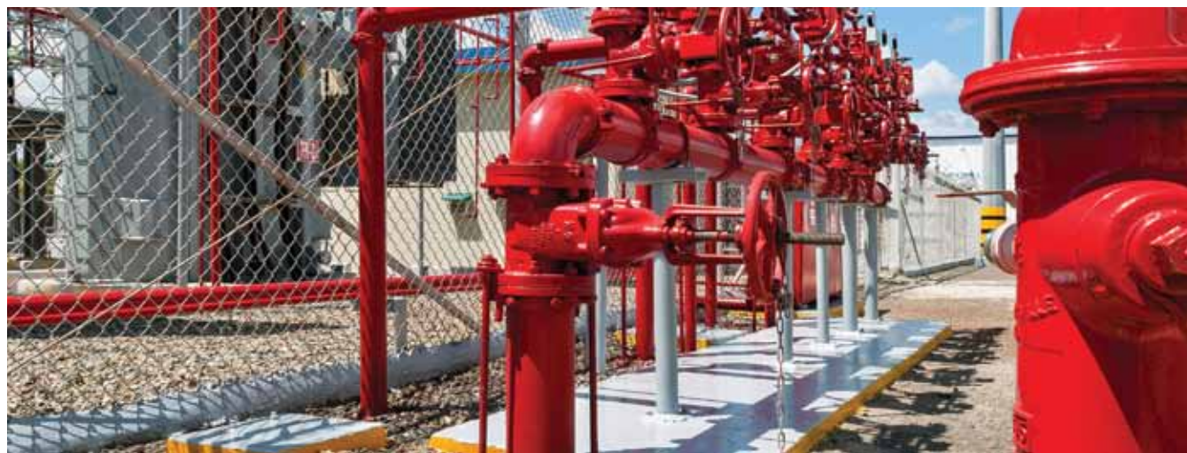
Sistema anti incendios de la planta principal. The main plant's fire prevention system.
