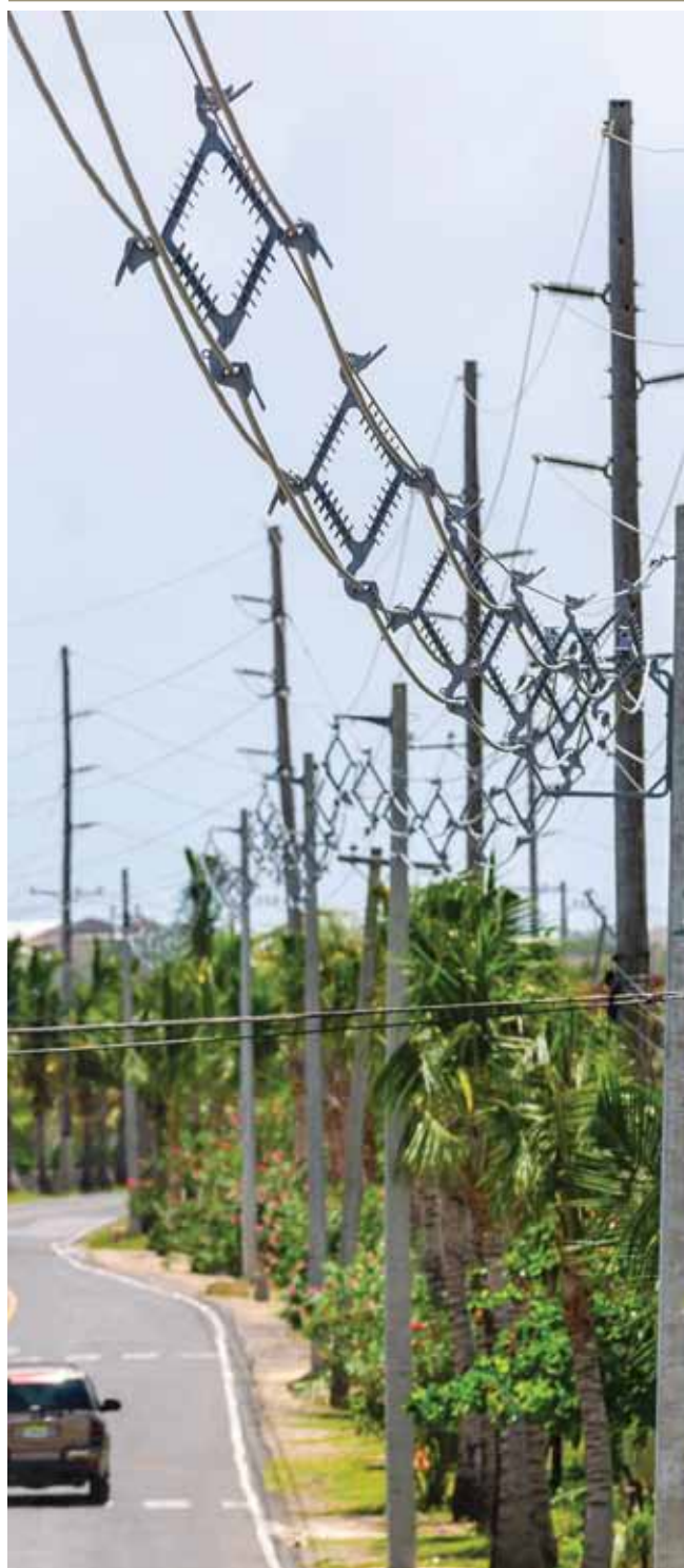
Línea de transmisión Hendrix, en Uvero Alto. Hendrix transmission line, at Uvero Alto.
