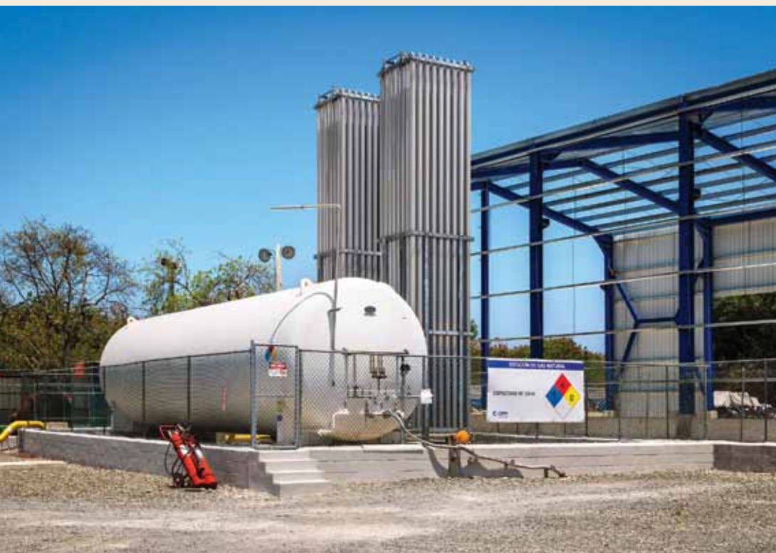
Estación de gas natural en nuestra planta principal. Natural gas station in our main plant.
