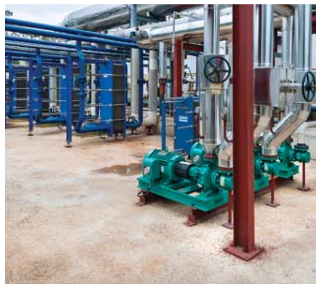
Estación térmica en Barceló. Thermal station at Barceló.
