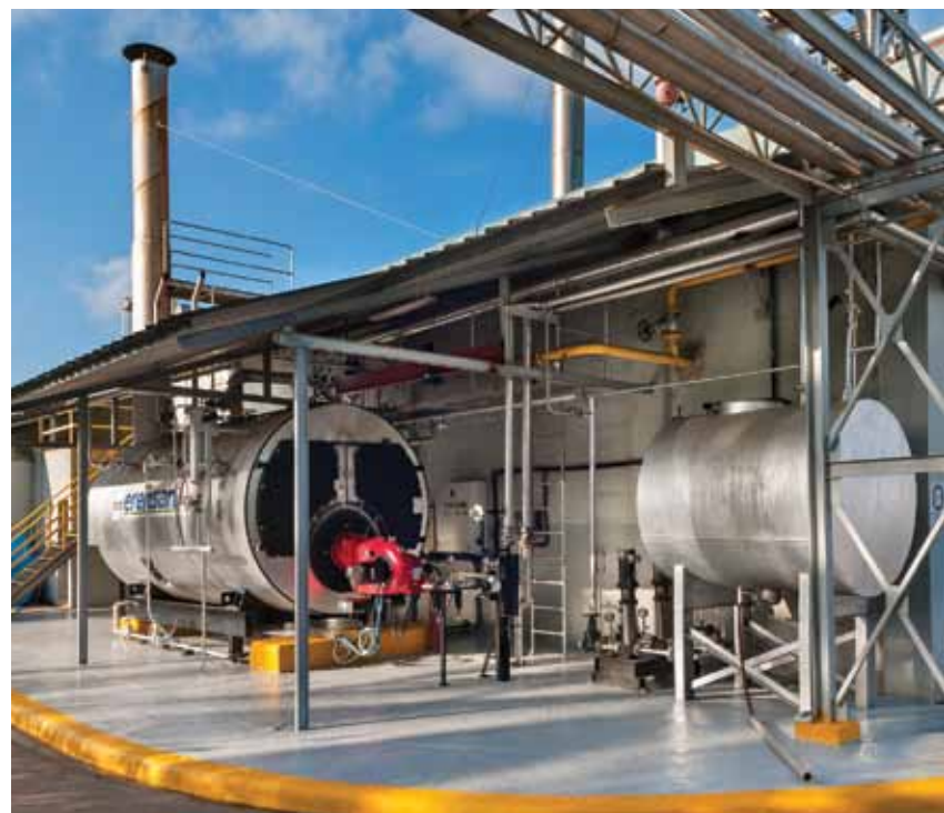
Nuestra caldera de erensan en Iberostar. Our erensan boiler at Iberostar.
