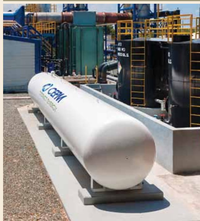
Parte de las tuberías del proyecto District Energy. Part of the District Energy Project pipes.
