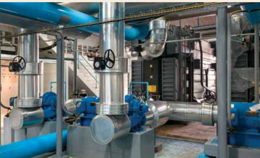
Tuberías de agua caliente y agua fría. Hot and cold water pipes.
