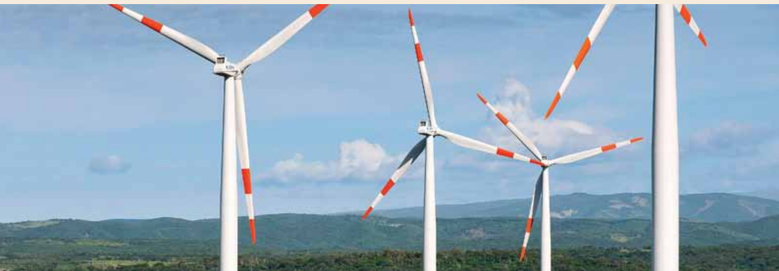
El Parque Eólico Quilvio Cabrera fue inaugurado en octubre de 2011. The Parque Eólico Quilvio Cabrera was inaugurated on October 2011.
