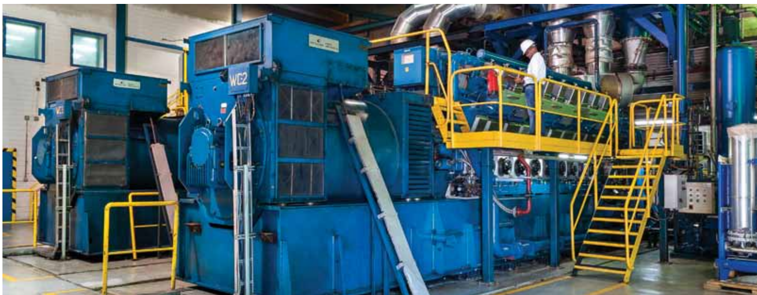
Motor de Gas Natural Punta Cana 5. Natural Gas Engine Punta Cana 5.
