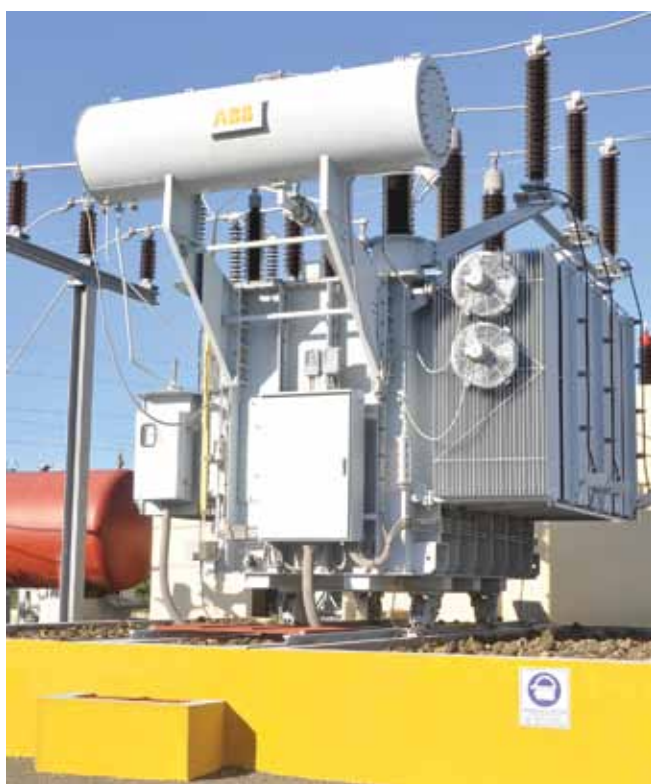
Uno de los transformadores de la planta. One of the plants converters.
